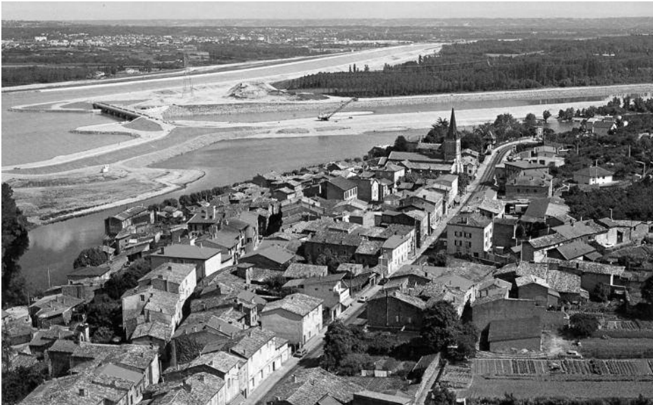
Fig. 2. Chantier de l'aménagement de Péage-de-Roussillon (Drôme), aménagement du Rhône mis en service en 1977. (Collection Rondeau; Maison du fleuve Rhône).
