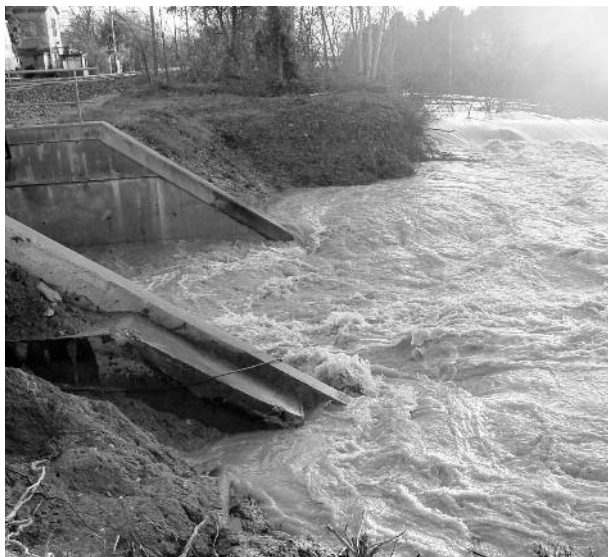
Fig. 7. Rupture de trémie dans la plaine entre Arles et Tarascon (4 décembre 2003).
